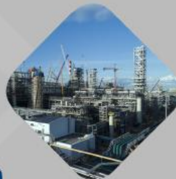
ГАЗОСНАБЖЕНИЕ ПРОИЗВОДСТВЕННОГО КОМПЛЕКСА "ИСТБОЛТРУС" Поставщик сети ресторанов МакДоналдс в России, г. Москва
