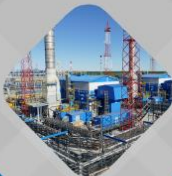
ГАЗОСНАБЖЕНИЕ ГТЭС "ТЕРЕШКОВО" 240 МВт, г. Москва
