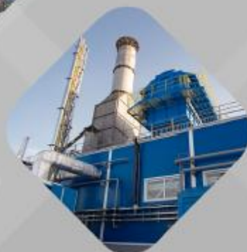
ГАЗОСНАБЖЕНИЕ ГТЭС "ЩЕРБИНКА" 690МВт, г. Москва
